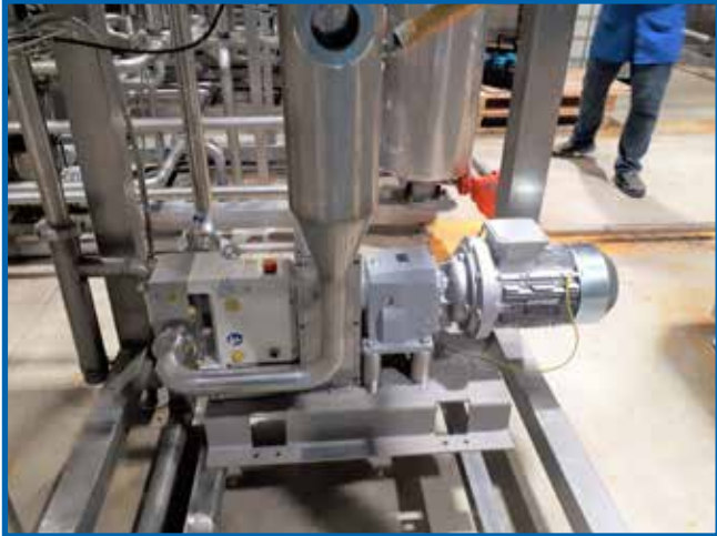
Liquide pompé - SLES 70%; 3 bar; 6 m 3 /h Pompe - LPX50-2
